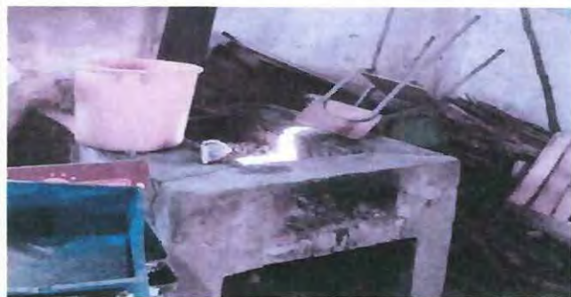
Foto1: Módulo 1 cocina, Reparación cocina, intervención estufa rural, demolición por la altura dificulta cocinar con ollas grandes.
